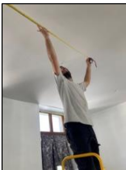
Électricité par Entreprise BRPE de Fresne St Mamès
